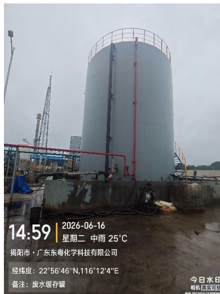
图 4-2 污水缓冲罐现场照片
